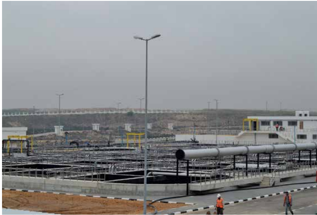
תחנה לטיפול בשפכים בצפון הרצועה. משרתת את האזור הצפוני צילום באדיבות CMWU
